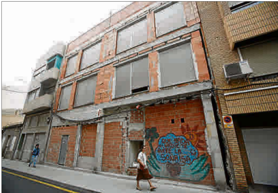
Aspecto que presentaba ayer el inmueble cuyas obras quedaron paralizadas en 2008. JOSÉ NAVARRO
